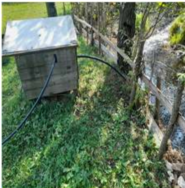
Slika 58. Crpna stanica za vodu koja služi za navodnjavanje poljoprivrednih kultura
