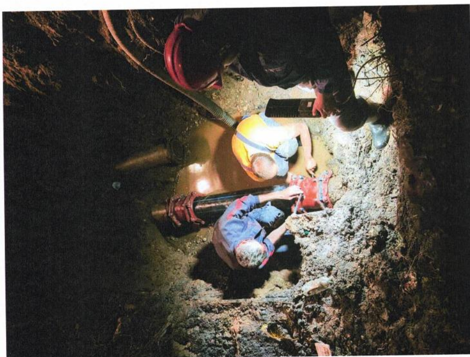
Slika: Popravka kvara na cijevi ACC DN 200 mm u mjestu Nedakusi
