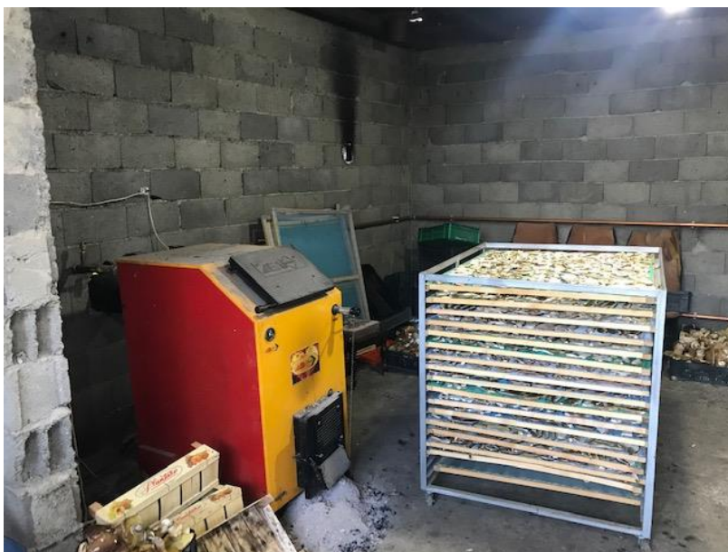
Slika 8. Unutrašnjost objekta, sušara sa kotlom snage 40 kW, septembar 2022.godine
