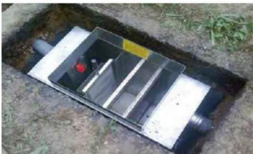
Sl.26. Hvatač masti i ulja-mastolov
